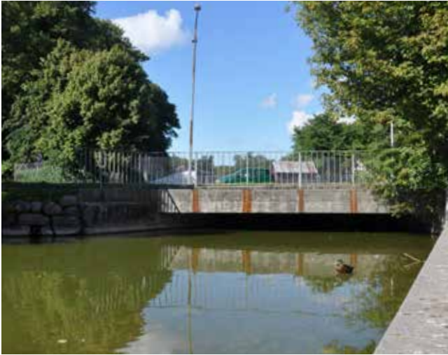
G - Kanalen som forsvinder under vejen. Vejoverføringen over kanalen svækker oplevelsen af kanalens både rekreative og funktionelle kvaliteter.
